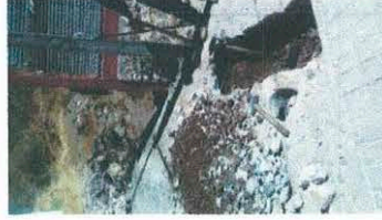
Rehabilitación de sistema de drenaje entre calle 5 de mayo y calle Francisco Sarabia
