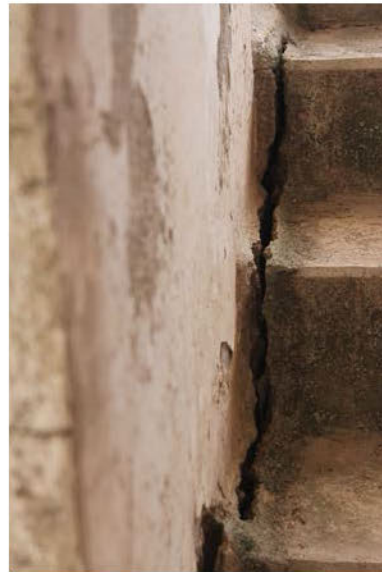
Foto: Grietas en escaleras del templo
