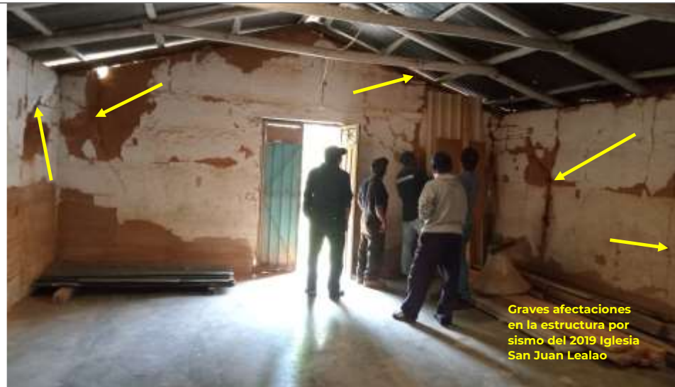
Imagen 18. Afectaciones por sismos
