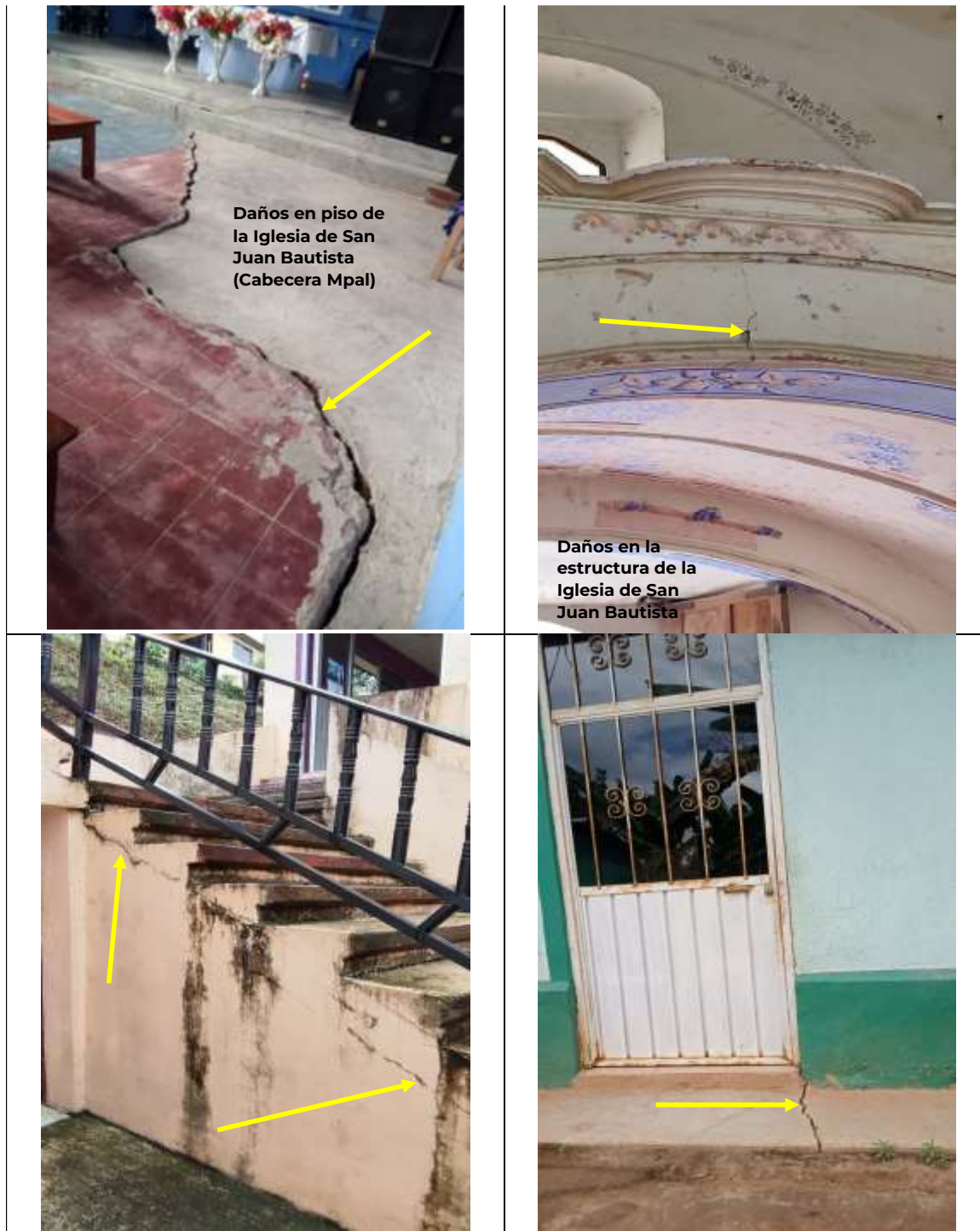
Imagen 17. Afectaciones por sismos
