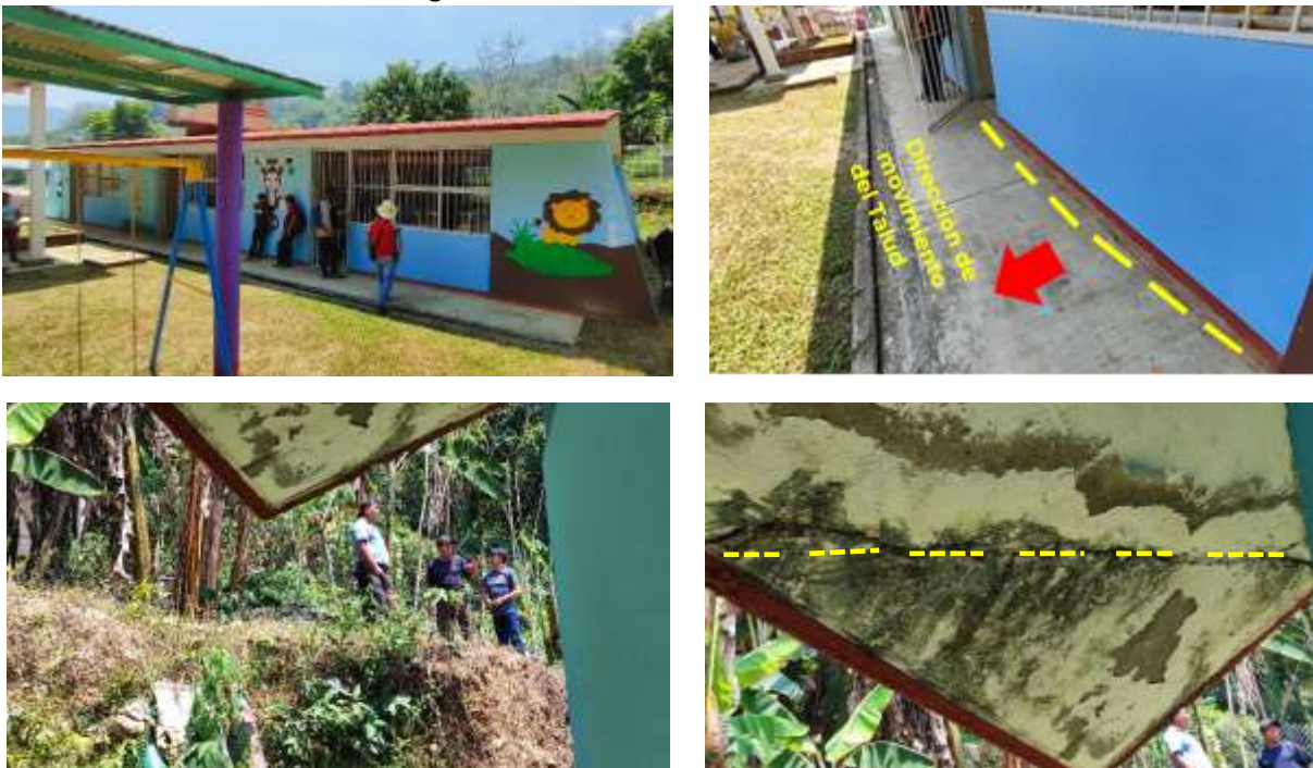
Imagen 9. Infraestructura educativa dañada
