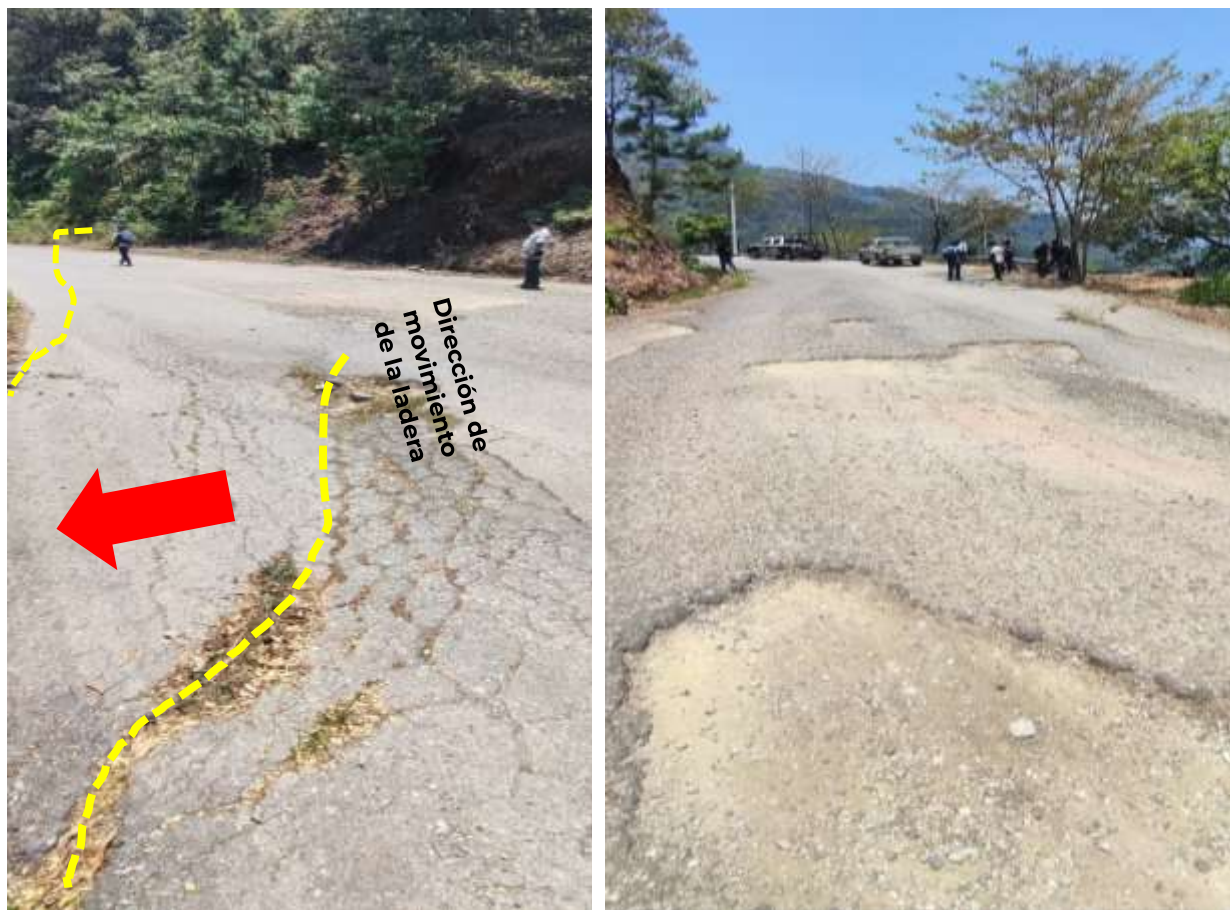
Imagen 8. Infraestructura carretera dañada
