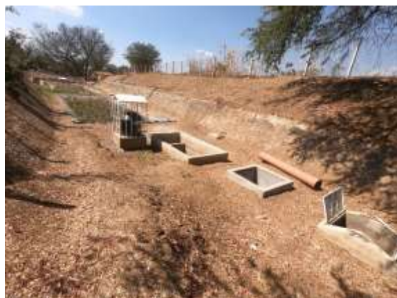
Imagen 6.3.11. Vista general de la PTAR (fuente: elaboración propia).
