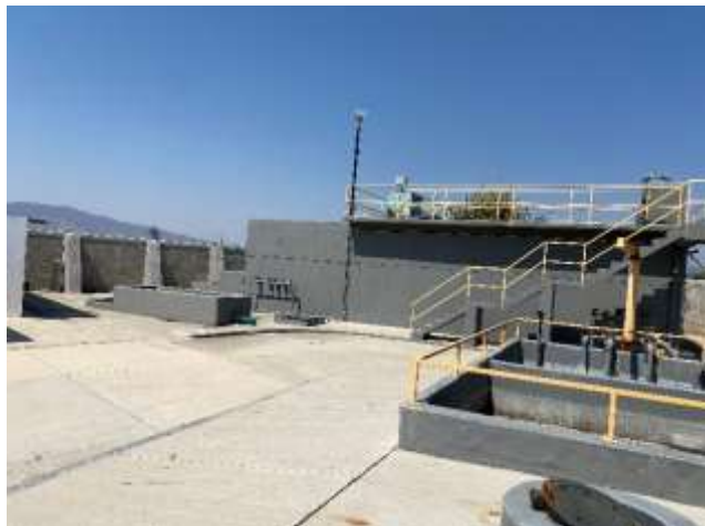
Imagen 5.32. Vista general de la PTAR (fuente: elaboración propia).
