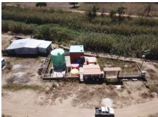
Imagen 5.36. Vista general de la PTAR (fuente: elaboración propia).
