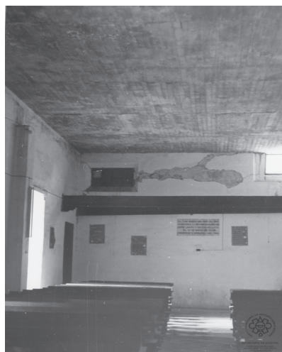
Figura 6. Muros dañados y cubierta de concreto armado. SECRETARIA DE CULTURA-INAH. Archivo Histórico y Planoteca Jorge Enciso/CNMH-MEX. "Reproducción Autorizada por el Instituto Nacional de Antropología e Historia".
