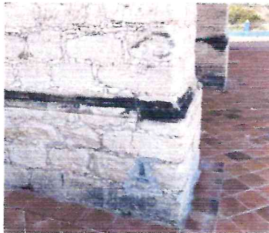
Imagen 5. Muro exterior con presencia de grietas, patina y eflorescencias.
