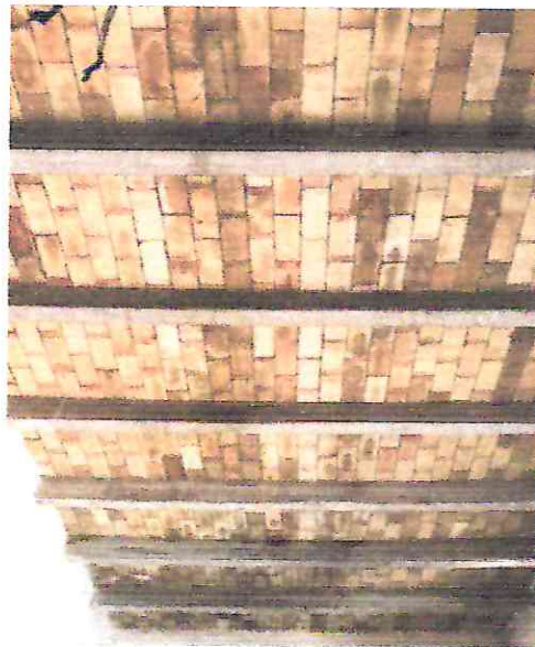
Imagen 3. Bóveda de tabique de barro recocido con presencia de grietas, humedad y eflorescencia.
