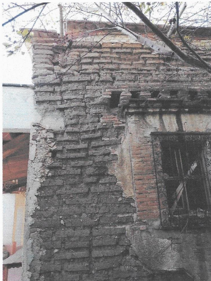
Imagen 04. Vista oriente de la casa cural, se observan grietas en el muro de adobe.
