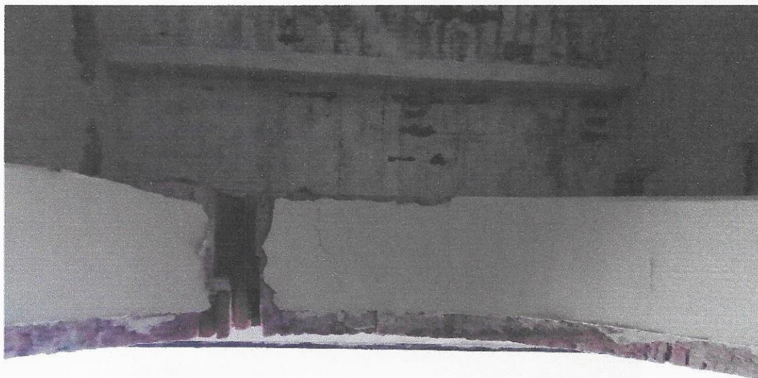
Imagen 12. Arcos Palacio municipal de Santiago Niltepec, Juchitán, Oaxaca. Fuente: Visita Técnica, septiembre 2021.
