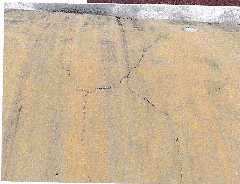
Imagen 12. Grietas en el entortado. Fuente: Visita técnica, septiembre 2021
