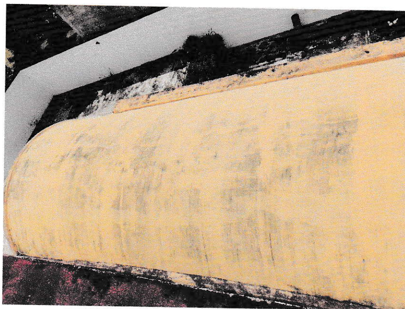
Imagen 13. Desprendimiento del entortado de bóveda de cañón corrido en la cúpula de la sacristía. Fuente: Visita técnica, septiembre 2021
