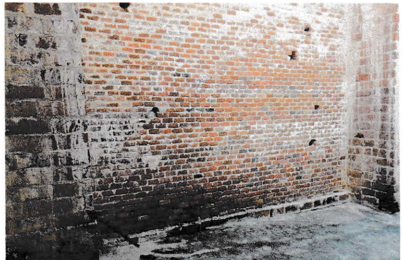
Imagen 18. Vista del daño con agrietamientos muros exteriores del "Templo de San Francisco Cozoaltepec" Fuente: visita técnica
