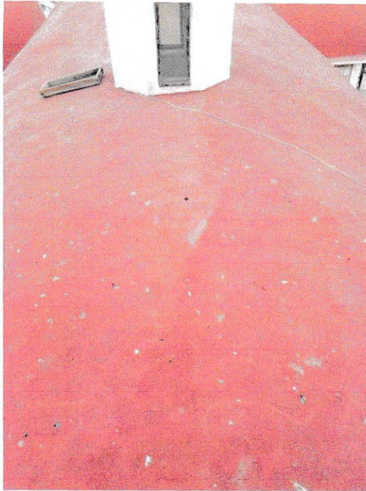
Imagen 15. Vista del daño con filtraciones en la cubierta "Templo de San Francisco Cozoaltepec" Fuente: visita técnica
