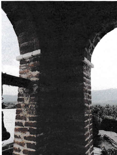
Imagen 17. Vista del daño con agrietamientos y fisuras en campanarios "Templo de San Francisco Cozoaltepec" Fuente: visita técnica
