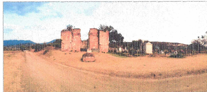
F-03 VISTA FRONTAL PONIENTE, SE OBSERVA DAÑOS OCASIONADOS POR SISMO
