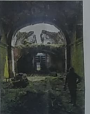
7. Vista de la fachada principal del templo, mostrando la estructura de la nave y la sacristía, con una parte de la nave principal y la sacristía.
