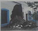
1. Vista de la fachada exterior deteriorada. Estado, después de haberse llevado a cabo los trabajos.
