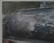
F-03 VISTA HACIA EXTRADOS DE BOVEDA DE CANON CORRIDA EN SACRISTIA, PRESENTA GRIETA A CAUSA DE SISMO.
