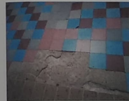
F-04 VISTA HACIA PISO DE LOCETA CON PRESENCIA DE ASENTAMIENTO Y DESPRENIMIENTO A CAUSA DE SISMO.
