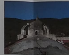
F-07 VISTA EN EXTRADOS DE CÚPULA EN PRESBITERIO. SE OBSERVA DAÑO A CAUSA DE SISMO.
