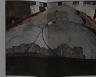
F-09 VISTA HACIA EXTRADOS DE BOVEDA. SE OBSERVA ENTORRADO CON PRESENCIA DE GREJAS A CAUSA DE SISMO.
