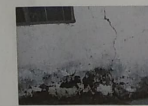
6. Vista exterior de esquina, presencia de humedad y efloresc. en base de paredes y deterioramiento de pintura por humedad excesiva.
