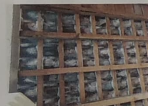
3. Vista del exterior de la fachada a base de muros de mampolen y ladrillo en base City Moderna, se está presentando deterioro por humedad de la base de las paredes, la presencia de columnas resaca y en algunos lugares deterioración.
