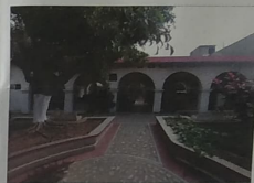
F-02 VISTA HACIA ALZADO PONIENTE CON PRESENCIA DE GREYAS EN COLUMNAS Y ARCOS A CAUSA DE SISMO.
