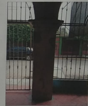
F-03 VISTA HACIA COLUMNA CON PRESENCIA DE GREYTA Y DESPRENDIMIENTO DE APLANADOS A CAUSA DE SISMO.
