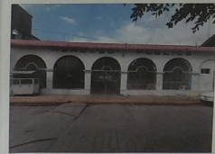
F-01 VISTA HACIA ALZADO ORIENTE CON PRESENCIA DE GREYAS EN COLUMNAS Y ARCOS A CAUSA DE SISMO.
