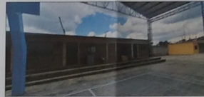
VISTA HACIA FACHADA LATERAL DEL PALACIO, SE DENOTA LOS MUROS A BASE DE TABIQUE DE BARRO ROJO, ASENTADO Y JUNTEADO CON MORTERO DE CEMENTO-ARENA.
