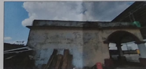
VISTA HACIA FACHADA LATERAL DEL PALACIO, SE DENOTA GRIETAS Y DESPRENDIMIENTO DE APLANADOS A CAUSA DE SISMO Y FALTA DE MANTENIMIENTO.
