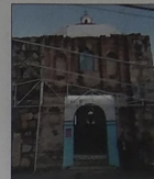
F-01 VISTA EXTERIOR HACIA FACEDA PONIENTE, SE OBSERVA PORTADA CON DAÑOS A CAUSA DE SISMO.
