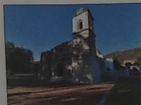
F-81 VISTA HACIA ALZADO SUR. SE OBSERVA PRESENCIA DE DAÑOS A CAUSA DE SISMO.
