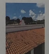
F-12 Visto del balcón que se parte de la cubierta del corredor de la planta baja.
