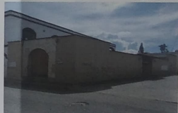
F-01 Visto exterior de la sección del edificio, se observa manchas de humedad provocando desprendimientos de pintura y presencia de hongos en paramentos exteriores.
