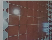
F-32 VISTA HACIA LOSETA CON PRESENCIA DE ASENTAMIENTO Y GRETAS A CAUSA DE SISMO.
