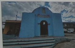
F-01 VISTA GENERAL FACHADA NORTE, ACCESOPRINCIPAL, FACHADA A BASE DE I CUERPO Y UN REPORTE EN FORMA DE ARCO. SE APPRECA TAMBIEN UN PAR DE CONTRAFUERTE.
