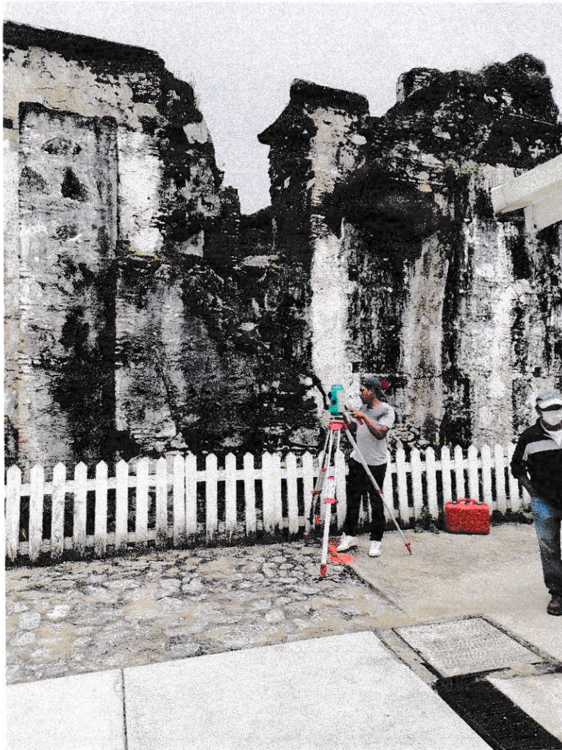
Imagen 14. Fractura del segundo entre eje y acceso al coro del Templo Antiguo de Santo Domingo. Fuente: Visita técnica septiembre 2021.
