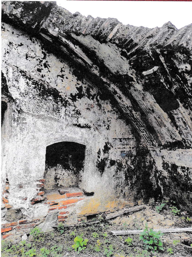
Imagen 15. Colapso parcial de la cúpula del coro, desprendimiento de la capa pictórica del Templo Antigo de Santo Domingo. Fuente: Visita técnica septiembre 2021.
