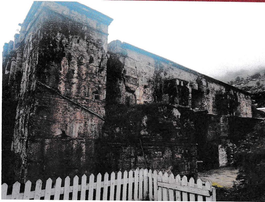
Imagen 16. Fractura de la fachada sur del Templo Antigo de Santo Domingo, que se proyecta hasta el bautisterio. Fuente: Visita técnica septiembre 2021.
