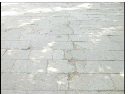
FOTO 12: En los pavimentos del zocalo se presentan deterioros como se observa en la imagen.
