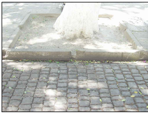
FOTO 8: Estado actual de pisos y jardinerías que conforman algunas zonas del zocalo.
