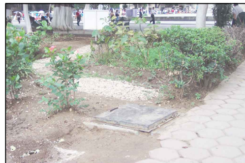
FOTO 11: Estado actual de piso en pasillos de plaza/zocalo.
