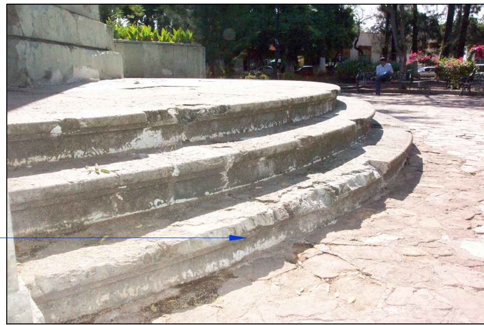
FOTO 2. ESCALONES DEL MONUMENTO CON DESPORTILLAMIENTOS, FRACTURAS, EXFOLIACIONES, DESGASTE NATURAL, PERDIDA DE JUNTAS, RESANES EN ALGUNAS ZONAS DE LA NAZIZ A A BASE EMPLESTES
