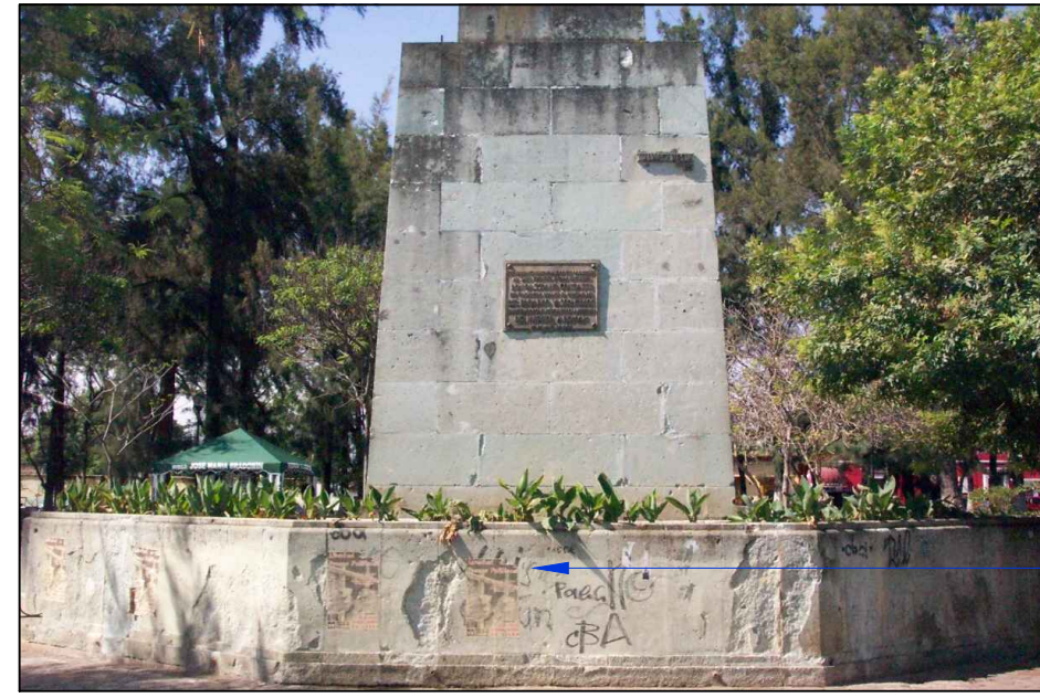
FOTO 5. PARTE POSTERIOR DEL MONUMENTO QUE PRESENTA FLORA MICROPARASITA EN LA PARTE SUPERIOR, EXFOLIACIONES EN LA BASE, GRAFITTY, DESPORTILLAMIENTOS EN ARISTAS.
