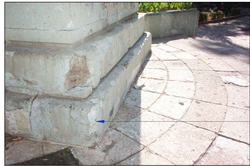
FOTO 3. DESPORTILLAMIENTOS EN ARISTAS DE LA BASE DEL MONUMENTO, EXFOLIACIONES EN EL DESARROLLO DE ESTA, DESPRENDIMIENTO DE SECCIONES DE LOS SILLARES QUE CONFORMAN ESTE ELEMENTO.
