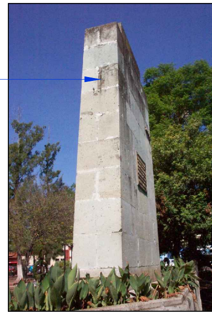
FOTO 6. SECCION LATERAL QUE PRESENTA FLORA MICROPARASITA, DESPORTILLAMIENTOS EN EL PERFIL Y EXFOLIACIONES
