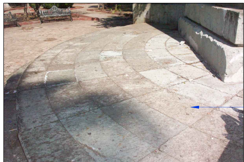
FOTO 1. PISO RADIAL QUE PRESENTA EXFOLIACIONES EN DIVERSAS PIEZAS, DESPORTILLAMIENTOS, PERDIDA DE JUNTAS, ASI COMO DESGASTE NATURAL
