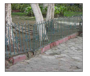
FOTO 13 HERRERIA QUE DELIMITA JARDINERAS EN MAL ESTADO, SECCIONES DESPRENDIDAS, DOBLADAS, Y FALTANTES
