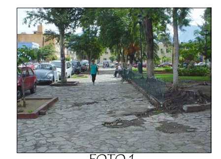
FOTO 1 DETERIOROS EN GUARNICION DE JARDINERAS QUE PRESENTAN FRACTURAS, DISGREGACIONES Y DESPRENDIMIENTO DE PINTURA VINILICA.
