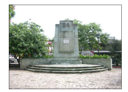
FOTO 4 PISO DE CANTERIA VERDE QUE PRESENTA DESPOSTILLAMIENTOS EN ESCALONES DE MONUMENTO, DISGREGACION DE JUNTAS Y PIEZAS EN ESTADO DELEZNABLE
