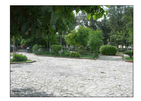
FOTO 2 DETERIOROS EN PISO DE PIEDRA, QUE PRESENTAN PIEZAS DETERIORADAS POR DESGASTE, INTEMPERISMO, DISGREGACION Y PERDIDA DE JUNTAS
