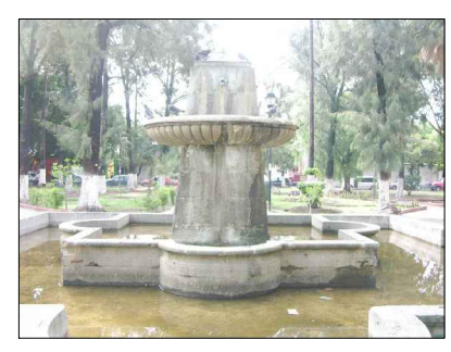
FOTO 5 FUENTE CENTRAL QUE PRESENTA PIEZAS DE PIEDRA DE CANTERIA VERDE EN MAL ESTADO, DEBIDO A INTEMPERISMO, PRESENCIA DE FLORA MICROPARASITA, DESPOSTILLAMIENTOS, FRACTURAS Y FALTA DE MANTENIMIENTO
