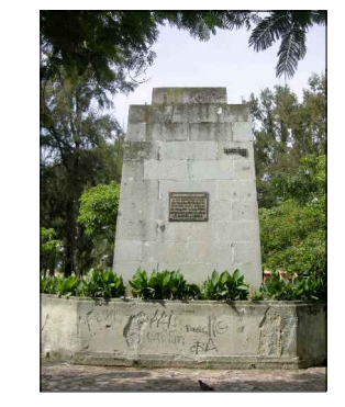
FOTO 3 DETERIOROS EN EN MURO Y BASE DE MONUMENTO DE CANTERIA VERDE QUE PRESENTA FRACTURAS DISGREGACIONES, VEGETACION MICROPARASITA Y PINTURA DE AEROSOL
