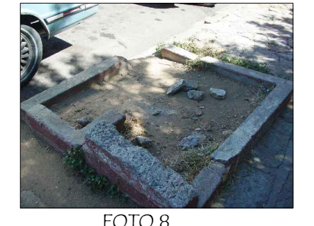
FOTO 8 JARDINERA QUE PRESENTA DESPOSTILLAMIENTO EN GUARNICION PERIMETRAL, DISGREGACIONES, FRACTURAS Y DESPRENDIMIENTO DE PINTURA VINILICA
