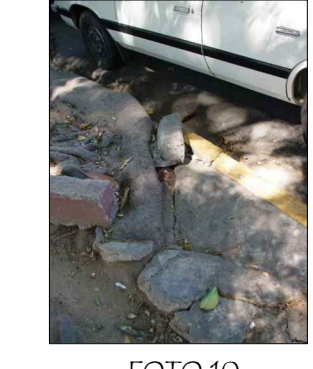
FOTO 10 FRACTURAS EN BANQUETA POR CRECIMIENTO DE VEGETACION, PISOS DE CANTERIA DESPRENDIDOS, GUARNICION FRACTURADA
