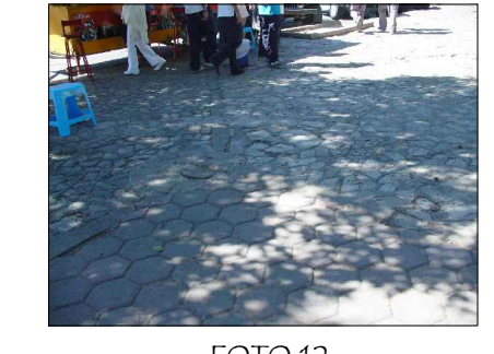
FOTO 12 PISO DE ADOQUIN QUE PRESENTA DESGASTE NATURAL, DESPOSTILLAMIENTOS, PERDIDA DE COHESION EN JUNTAS
