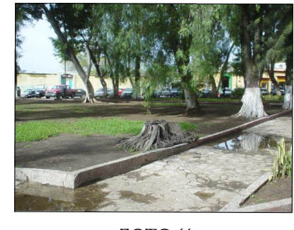
FOTO 11 PASILLO INTERIOR QUE PRESENTA ACUMULACION DE AGUA DEBIDO A PERDIDA DE PENDIENTE Y ASENTAMIENTO DE TERRENO NATURAL
