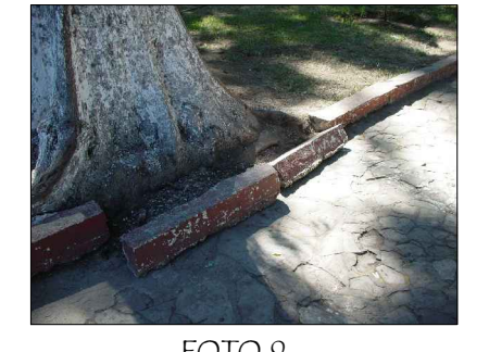
FOTO 9 GUARNICION PERIMETRAL DE JARDIN FRACTURADA POR CRECIMIENTO DE RAICES, COLOCACION DE INSTALACIONES PARA PUESTOS AMBULANTES
