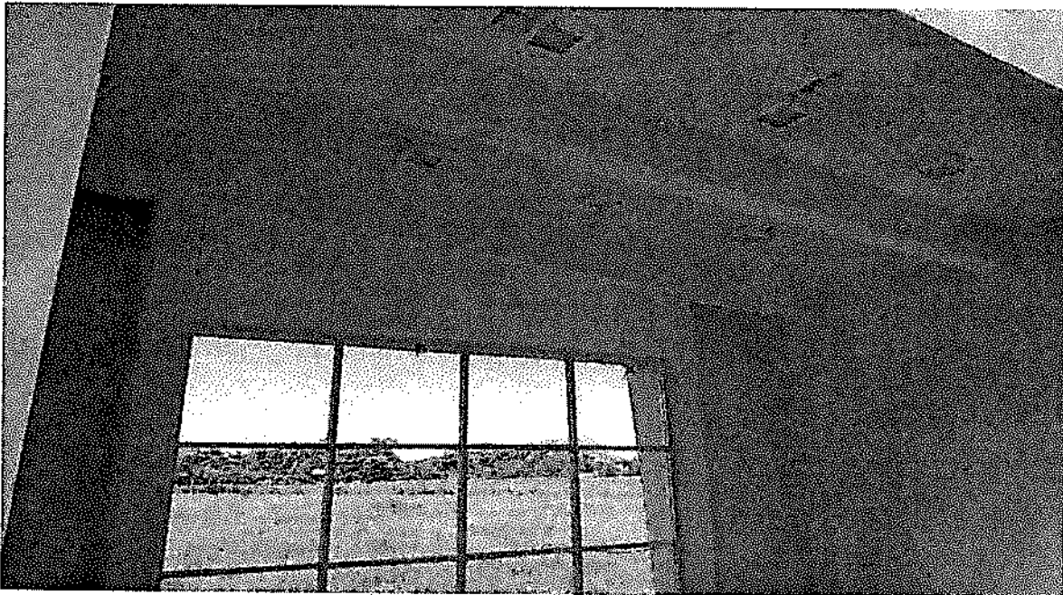
TECHO DEL ACCESO AL AUDITORIO CON FILTRACIONES FALTA QUE LO PINTEN
