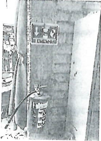
Fig. 3 Primer extintor contra incendios en el centro de acopio del C. JOSÉ ÁNGEL JUÁREZ
