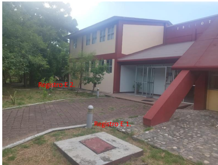
Conexión entre registro eléctrico 1 y 2
