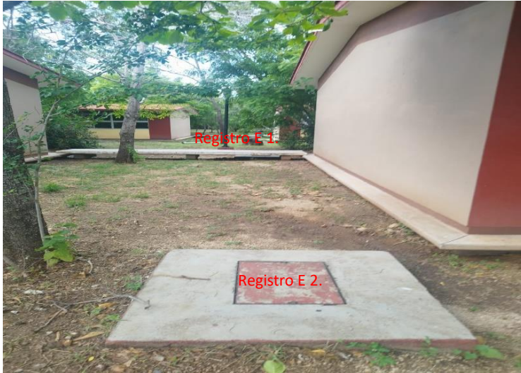
Conexión entre registro eléctrico 1 y 2
