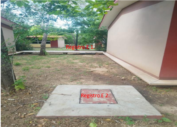
Conexión entre registro eléctrico 1 y 2
