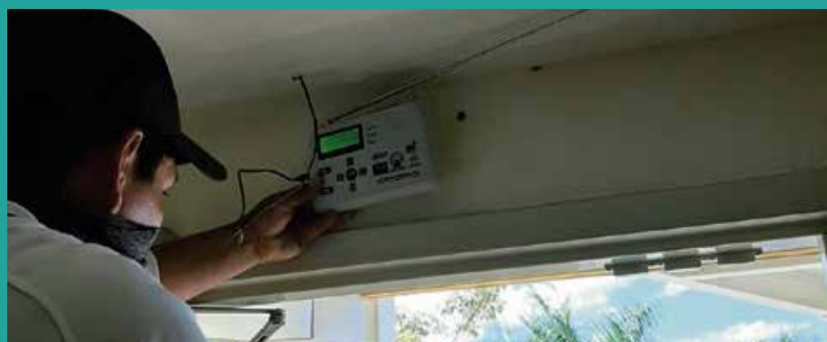
Se encuentran instalados 321 radios Sarmex en los edificios de Ciudad Administrativa, Ciudad Judicial y el AGEO
